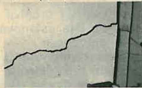
Zidovi su vidljivo popucani
