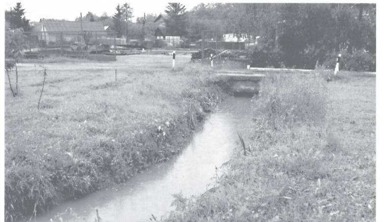
Neočišćeni kanali i putni jarci te začepljeni propusti uzrokuju poplave
