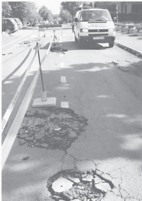
Dan poslije - oštećenja na kolniku
